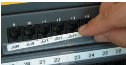
Labels voor aansluitklemmen en patchpanelen
